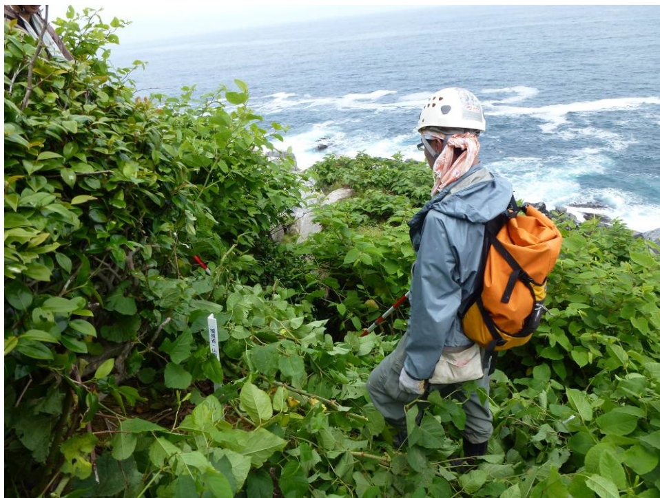
写真6 固定調査区 No. 10、東端終点崩落部 (2012年6月12日)
