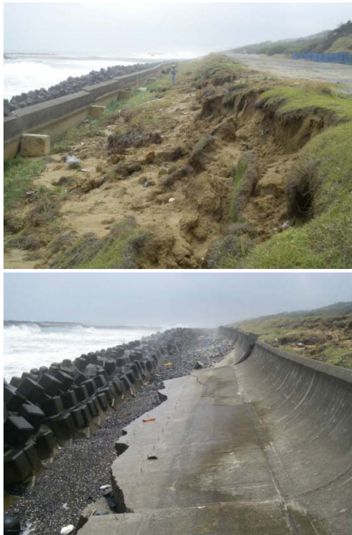
図 5.2-37 地震動と津波により被災した護岸（H23(2011)年 7 月 25 日撮影）
