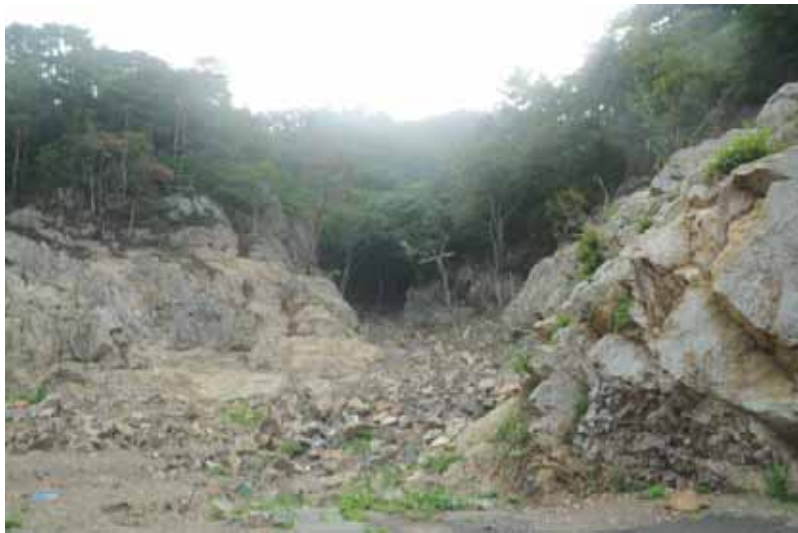
がけ崩れの痕跡
