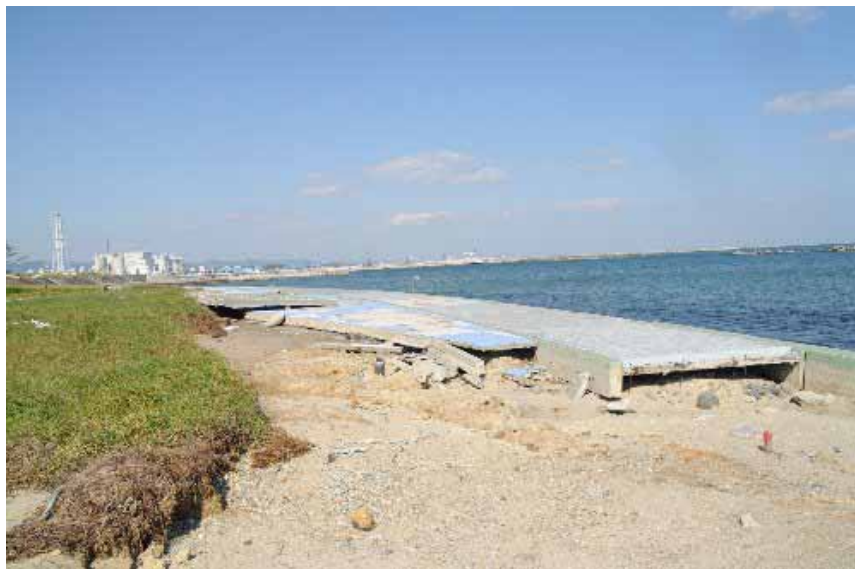
地面がえぐられた跡
