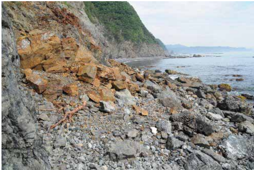
崩壊した断崖
