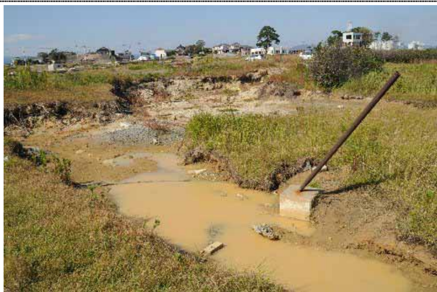
地面がえぐられた跡
