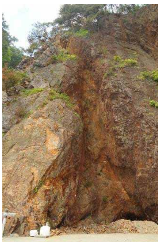
崩壊した断崖
