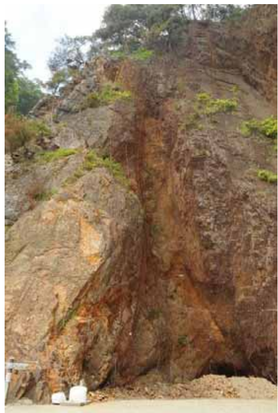
がけ崩れの跡
