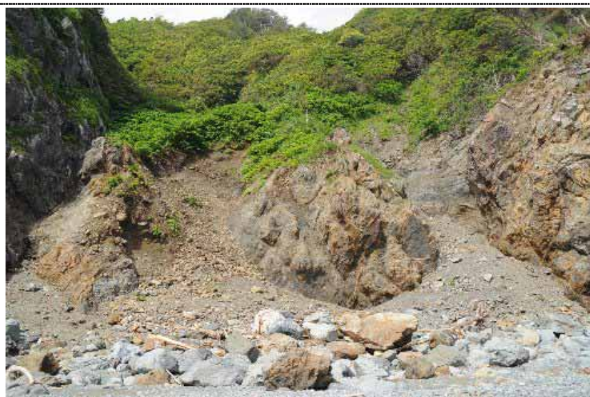
崩壊した断崖
