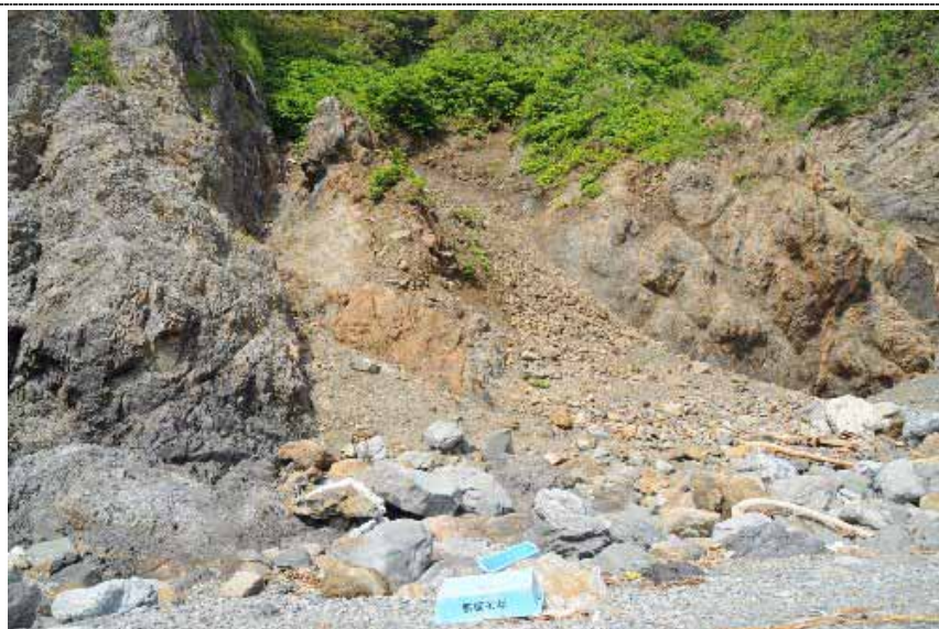
崩壊した断崖
