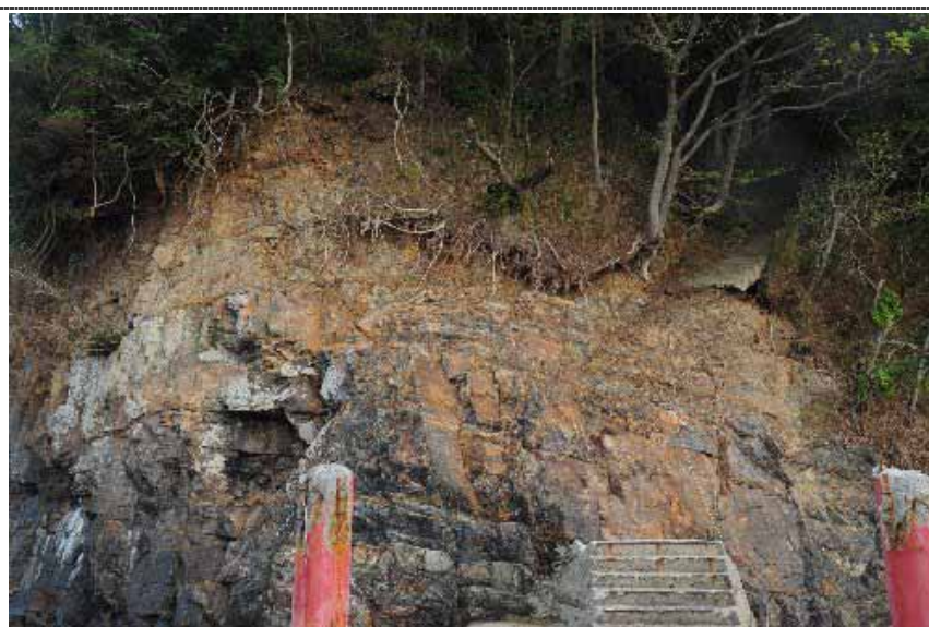
崩壊した岩壁
