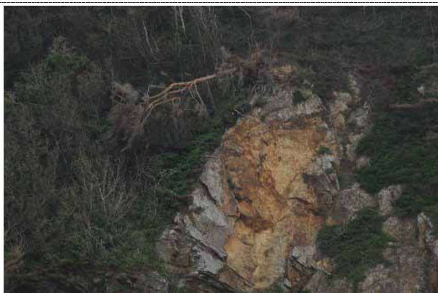
岩壁の崩壊部と倒された松
