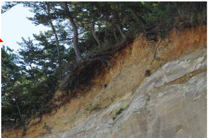
浸食された岩壁上端部
