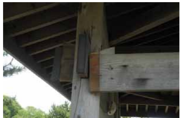
柱がはずれた部分
