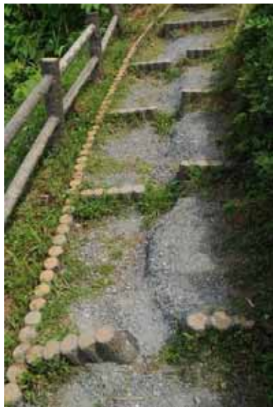
地割れ発生部分
