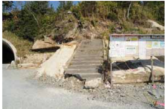
損壊した階段
