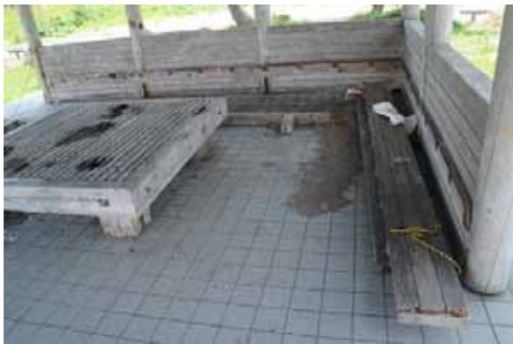
内部の状況（ベンチ部分が損壊）
