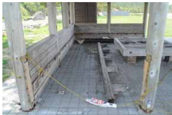
壁面の流出部
