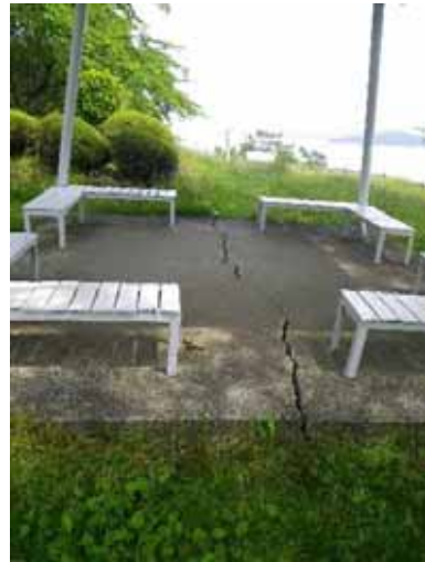
東屋基礎の亀裂
