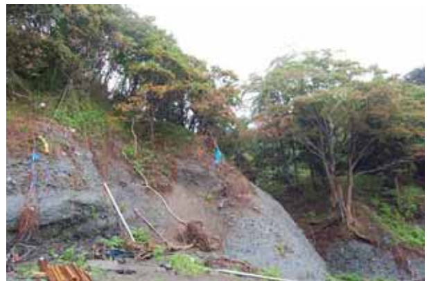
(参考) 斜面が崩壊し、ごみも溜まっている
