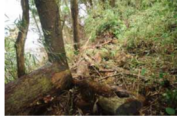
歩道横の斜面が崩壊
