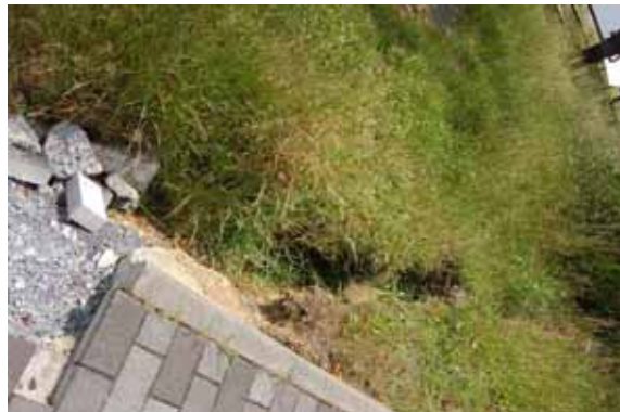
地割れによる歩道の損傷
