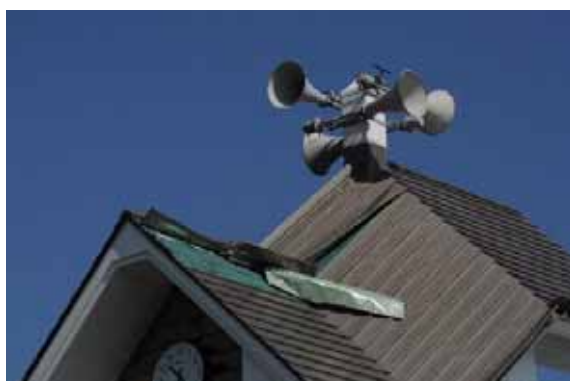
屋根の損壊部分
