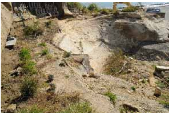
がけ崩れにより崩壊した歩道
