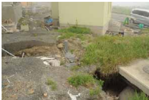
陥没した路盤
