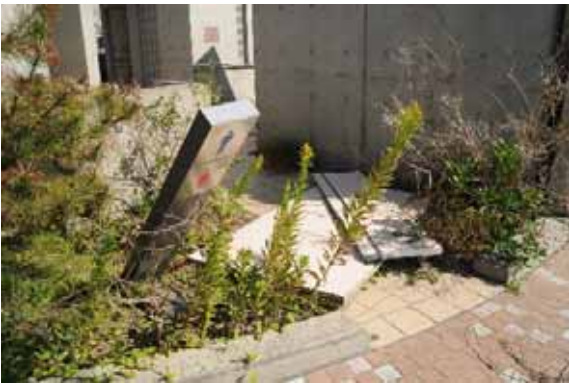
トイレ入口付近
