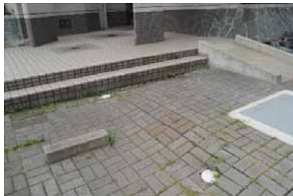
トイレ前のゆがんだ地盤
