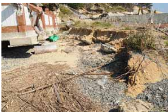
浸食された地盤
