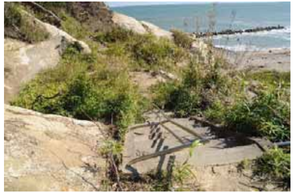
押し曲げられた手すり
