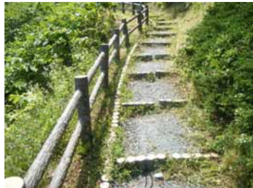
被災前の 地割れ発生部分 (写真：青森県提供)
