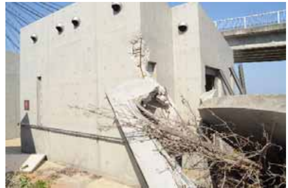
損壊した壁面
