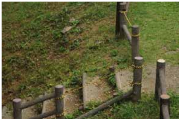
損壊した手すり
