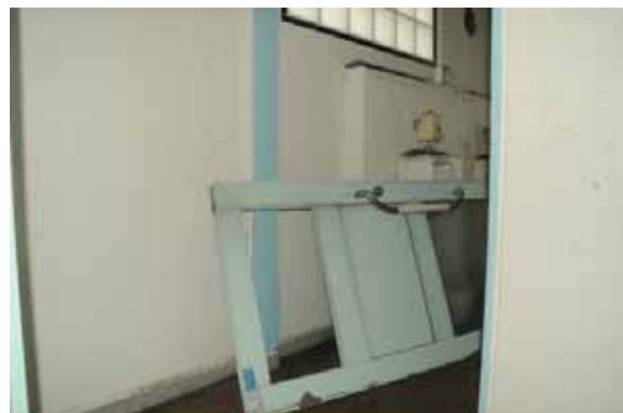
破損した入口ドア
