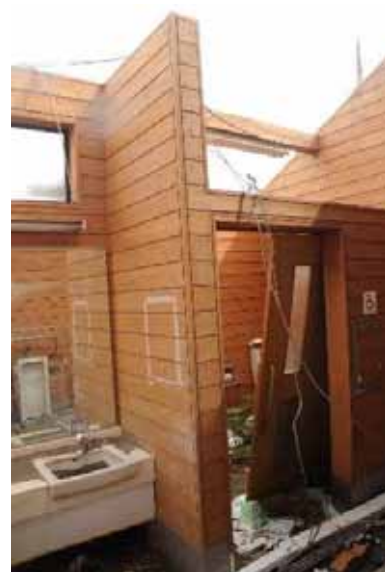
内部（屋根、扉の損壊）
