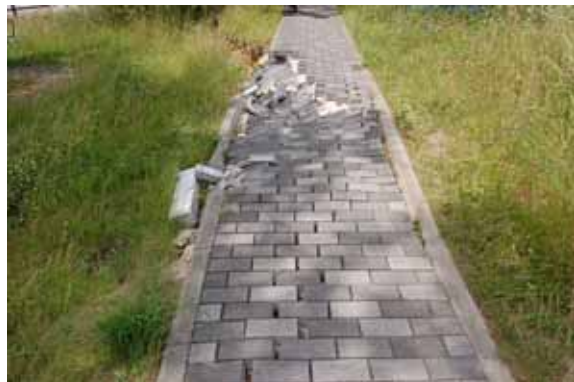
歩道の崩壊箇所
