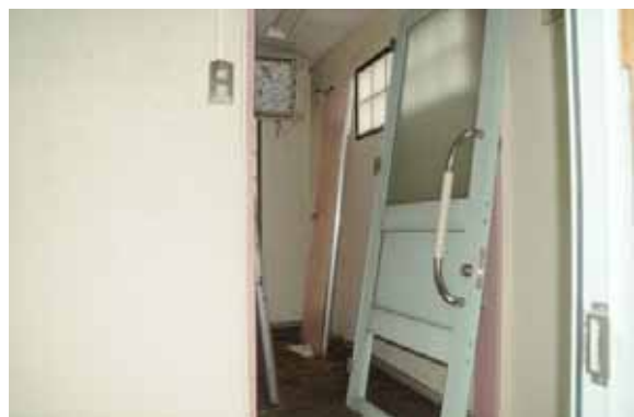
破損した入口ドア、ブースドア
