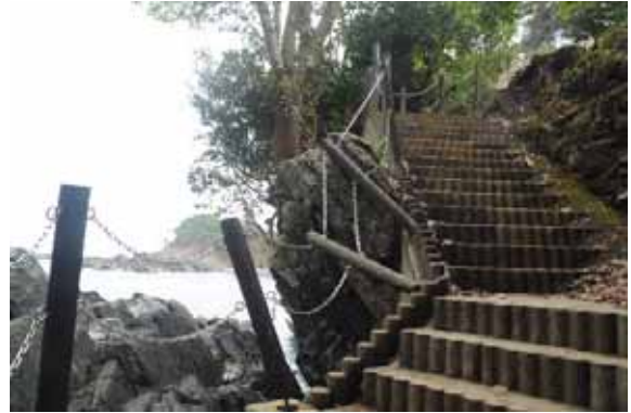
損壊した手すり
