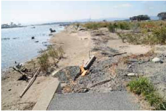
地盤ごと流出した歩道
