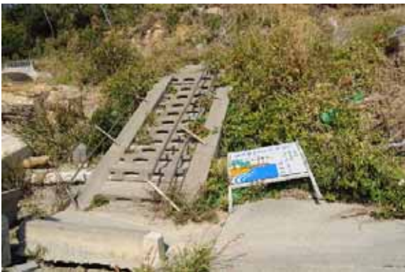
損壊した階段
