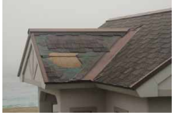
屋根の破損部分
