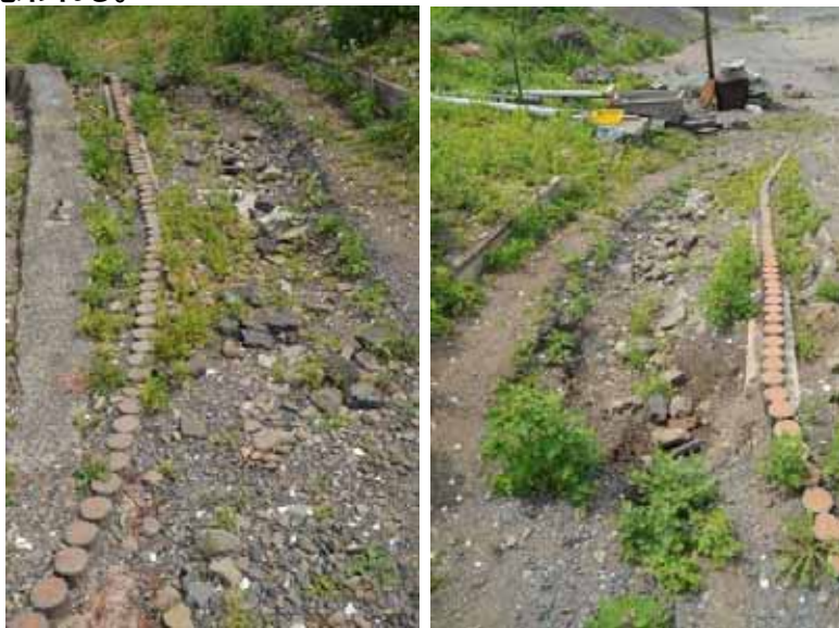
えぐられた歩道
