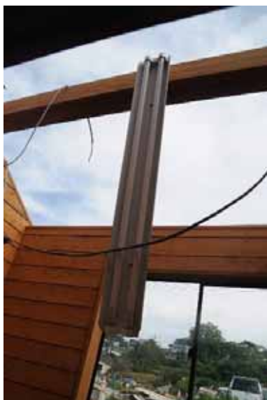
内部（照明の損壊）
