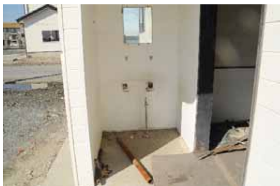
損壊した洗面所
