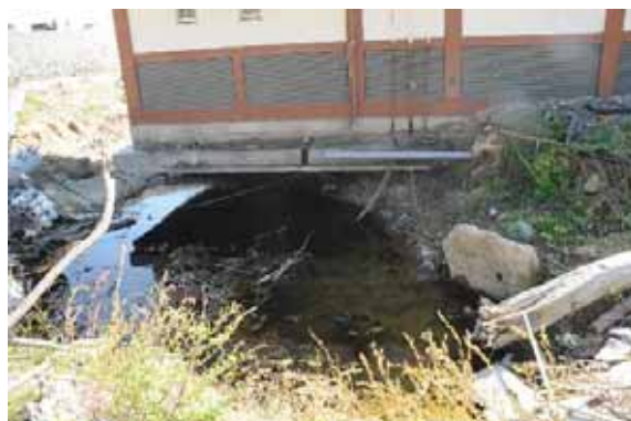
浸食された地盤
