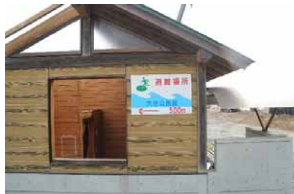
損壊した窓と津波避難の標識
