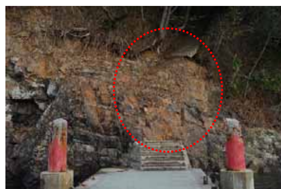
歩道の崩壊部分
