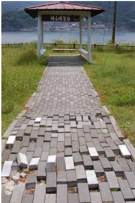
歩道の損壊箇所
