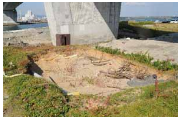
浸食された地盤
