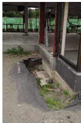
舗装部分の損壊
