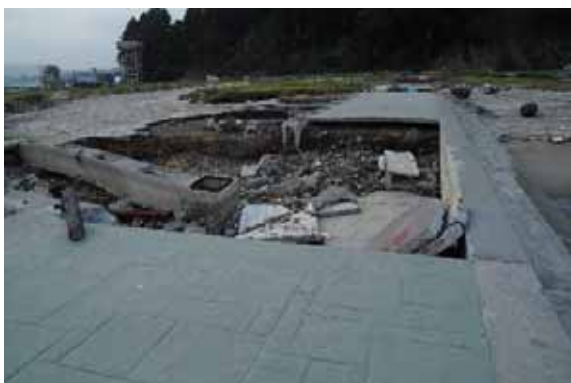
歩道の崩壊部分
