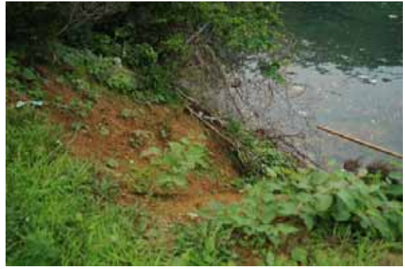
路肩の崩壊面（左写真の場所）
