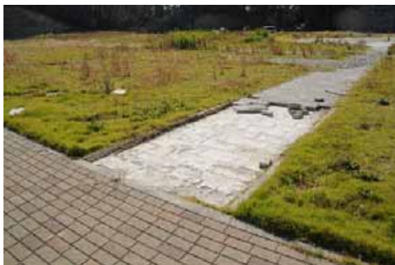
剥がされた舗装
