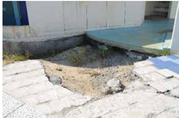
舗装が剥がされた跡
