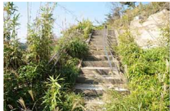
押し曲げられた手すり
