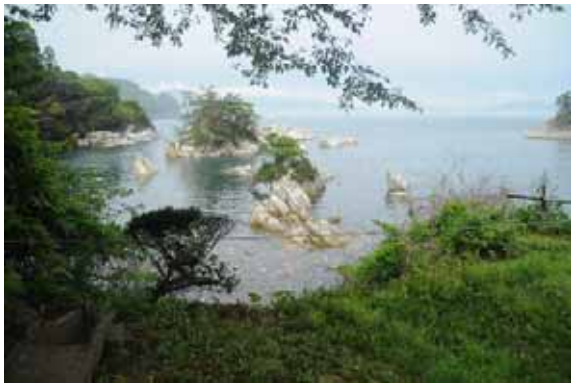
海側の路肩が崩壊（ロープが張られている）
