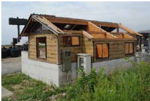
全景（窓や屋根が損壊）
