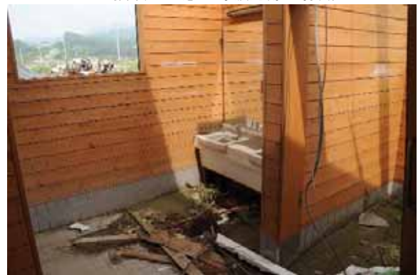
内部（窓、屋根が損壊、泥が堆積）
