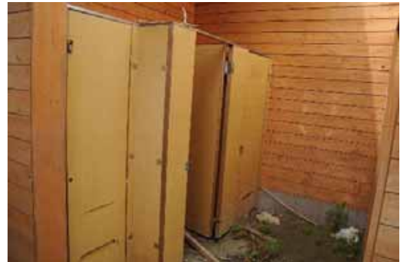
内部（泥や板材等が堆積、扉が損傷）
