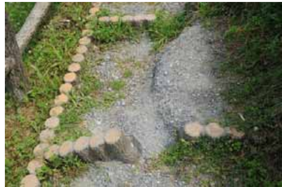
段差発生部分
