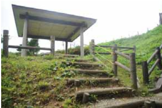
東屋前の階段（手すりが損壊）
